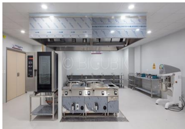
EQUIPAMIENTO DE COCINA
